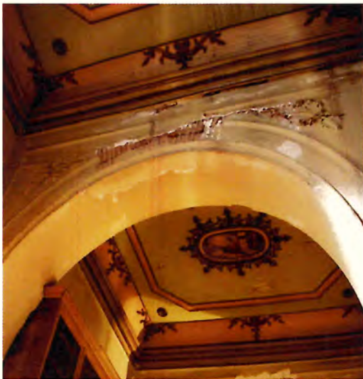
Foto 6: Muestra el descascamiento del estuco en la clave del arco transversal de la nave lateral como consecuencia del terremoto de 2010.
