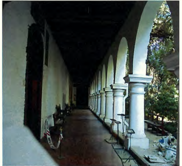
La Foto 7: Muestra la estructura del patio de la iglesia sin daño, al lado se ven los escombros producto de la limpieza, los que se muestran en la Foto 8.
