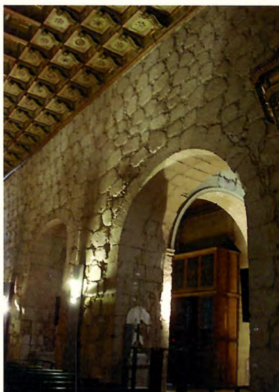
Foto 3: Muestra el detalle del muro de arcos de piedra del eje longitudinal 1 de la Figura 1.
