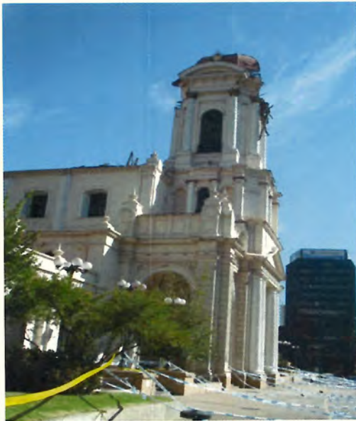
Foto 10: Muestra el daño a la torre de la iglesia de la Divina Providencia, para el terremoto de 2010.
