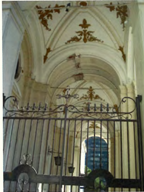
Foto 11: Muestra los daños en la clave del arco en la iglesia de la Divina Providencia y su tensor de acero horizontal.
